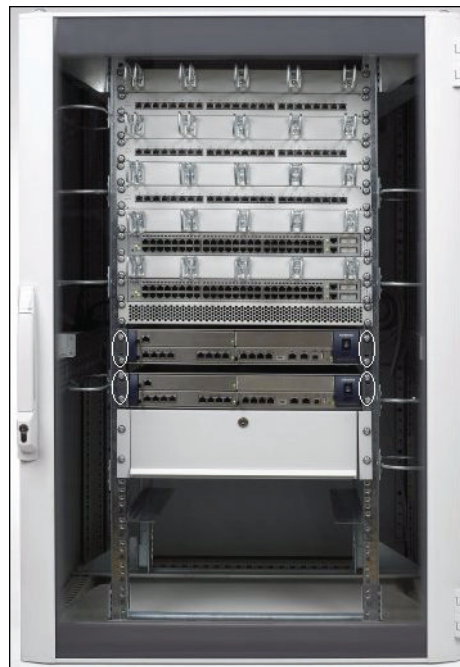
Figure: 2 boîtiers système OpenScape Office MX dans l'armoire 19"
